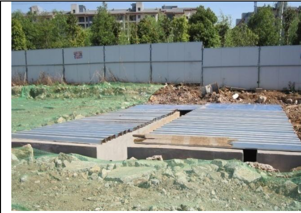
依托使用的片区内沉砂池
