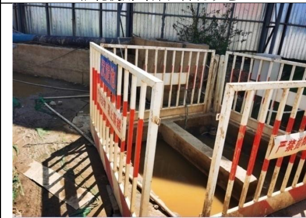
项目区实施的沉砂池
