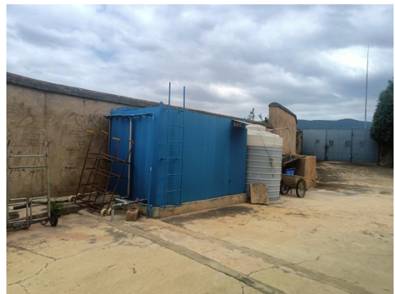
依托的污水处理站
